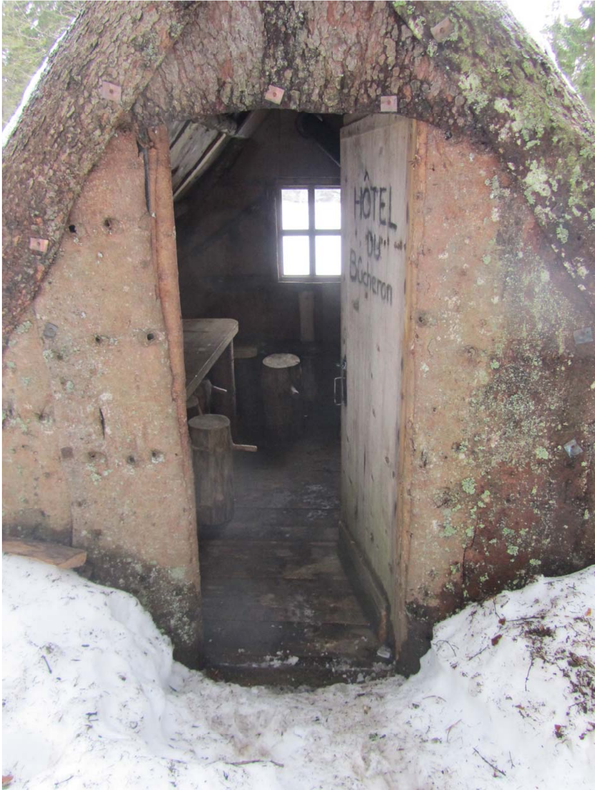
La cabane vous accueille. Les derniers visiteurs ont oublié de refermer entièrement la porte. Le sol intérieur est très humide.
